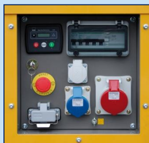
Panou de control
